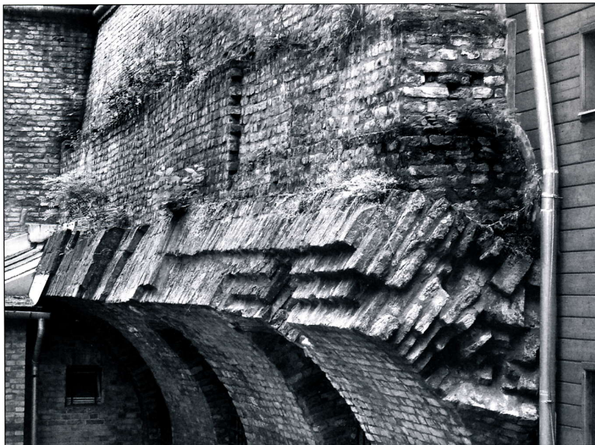
■ 3. kép: Lefolyástalan korabeli falazat felületi védelem nélkül a szegedi vár falánál ■ Photo 3. Period masonry without run-off and surface protection at the walls of Szeged Castle
