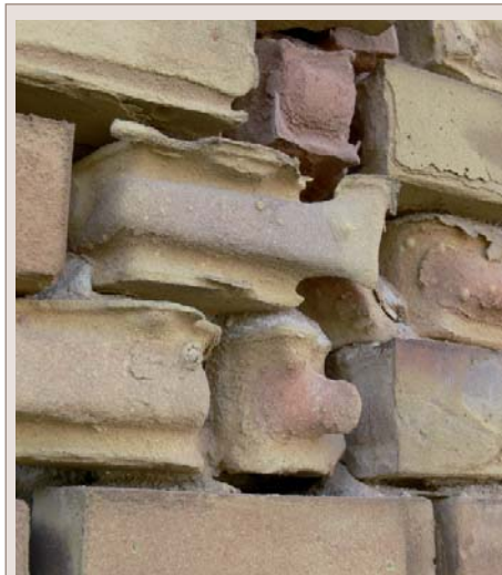
A falazóanyag roncsolódása a nedvesség és sókorrózió miatt
